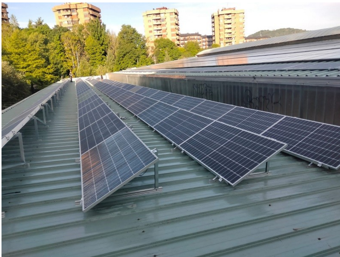
Nueva instalación fotovoltaica en el polideportivo Pío Baroja
